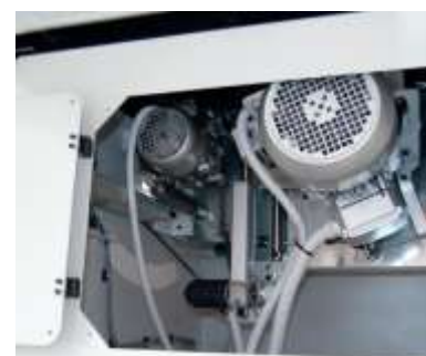
Elevação e inclinação motorizada do disco principal
